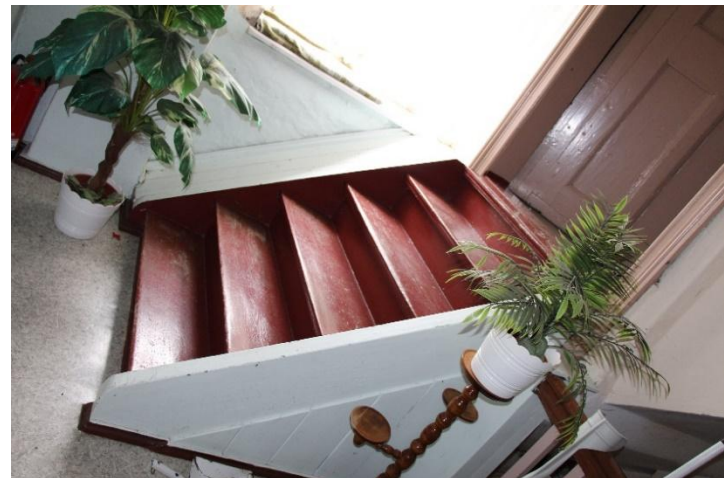
Escaleras para el acceso hacia el ático y torre del ala Sur del Castillo de Mühlberg.
